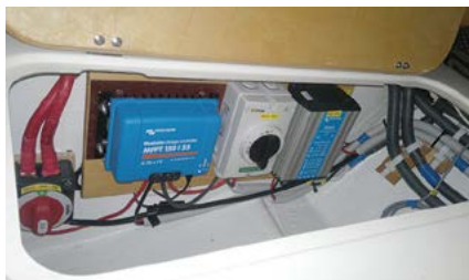
Elementy instalacji elektrycznej ukryte w bakiście.
